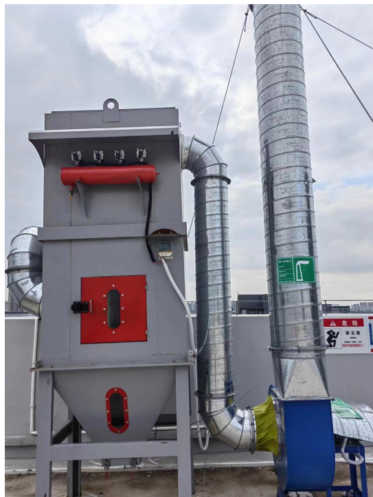
图 4.1-11 DA002 废气排放口
