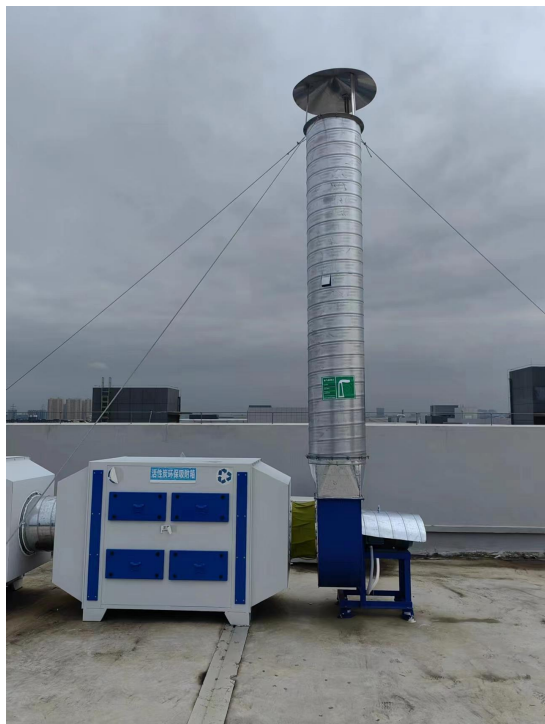
图 4.1-10 DA001 废气排放口
