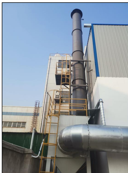
图 4.1-9 滤筒除尘器 (TA004) +DA002 排气筒
