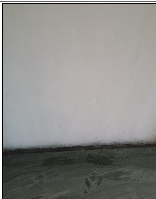
4.1-20 危废库防腐防渗、导流沟
