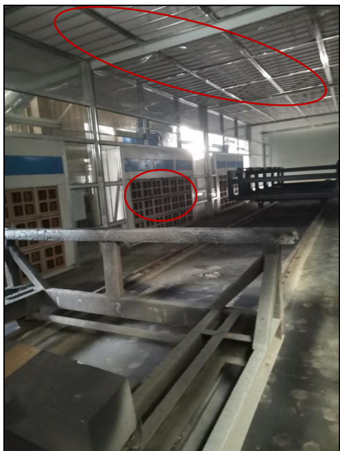
图 4.1-11 喷漆房内部过滤
