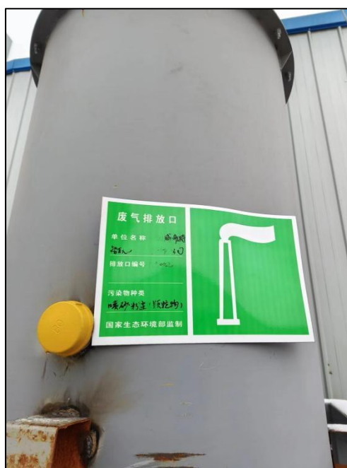
图 4.2-4 DA002 排气筒标识
