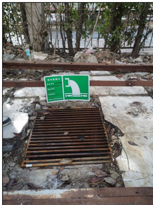
图 4.2-2 雨水排放口标识
