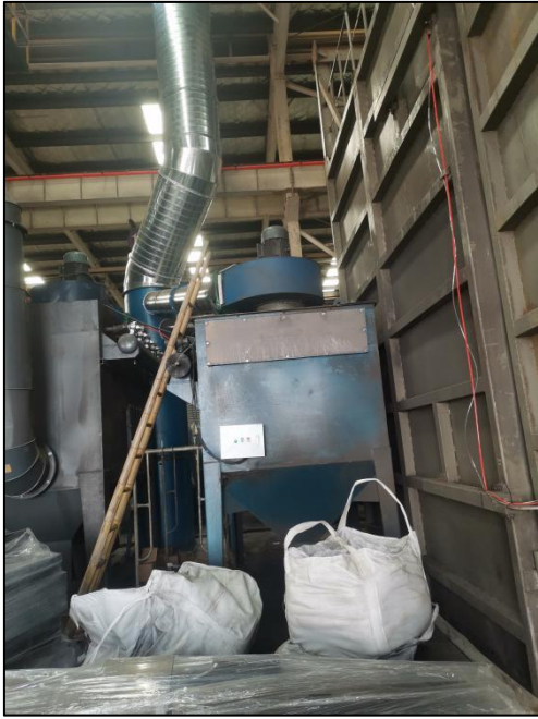
图 4.1-5 一级旋风分离器+二级滤筒除尘器 (TA003)
