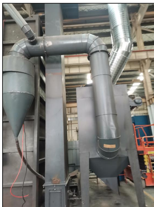
图 4.1-4 旋风分离器+二级滤筒除尘器（TA002）
