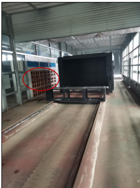
图 4.1-12 喷漆房内部过滤
