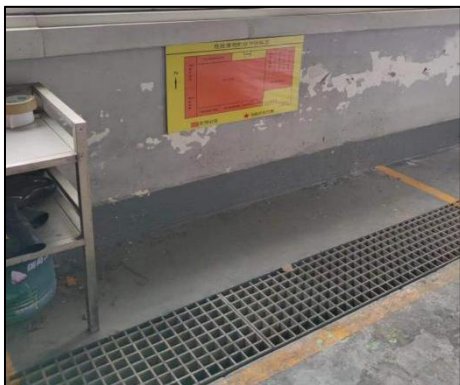
图 4.2-1 危废库导流沟
