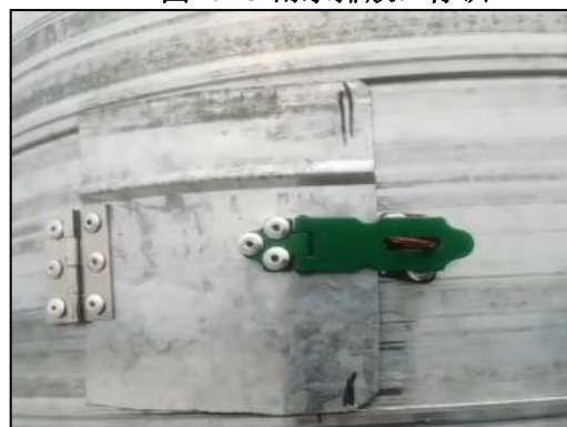
图 4.2-8 DA003 排气筒废气监测孔
